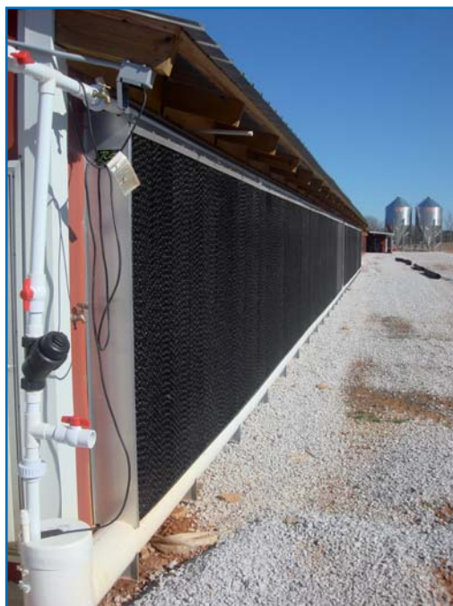
Figura 45: Primer postavljenog saća za hlađenje na bočnom zidu objekta (u “kućici”).
