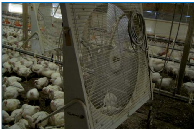
Figura 29: Recirkulacioni ventilatori u objektu sa prirodnom ventilacijom.
